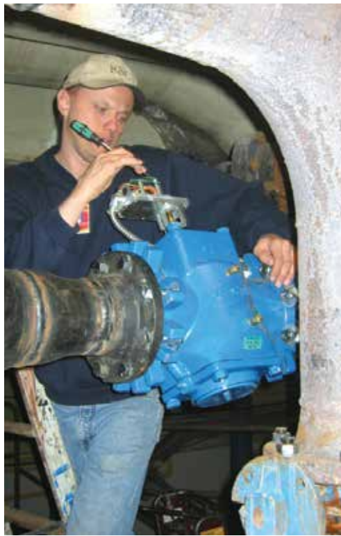
Alfred Veldman, de ESC Automation, Vancouver, B.C., establece el flujo en una válvula de control independiente de presión Griswold Controls MVP™.
